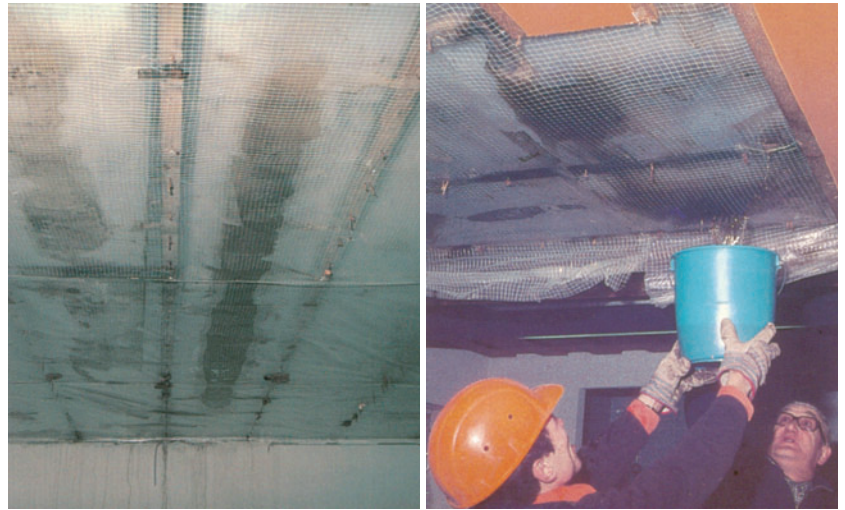
Abb. 3: Wasseransammlung in der Decke über einem Schwimmbad
