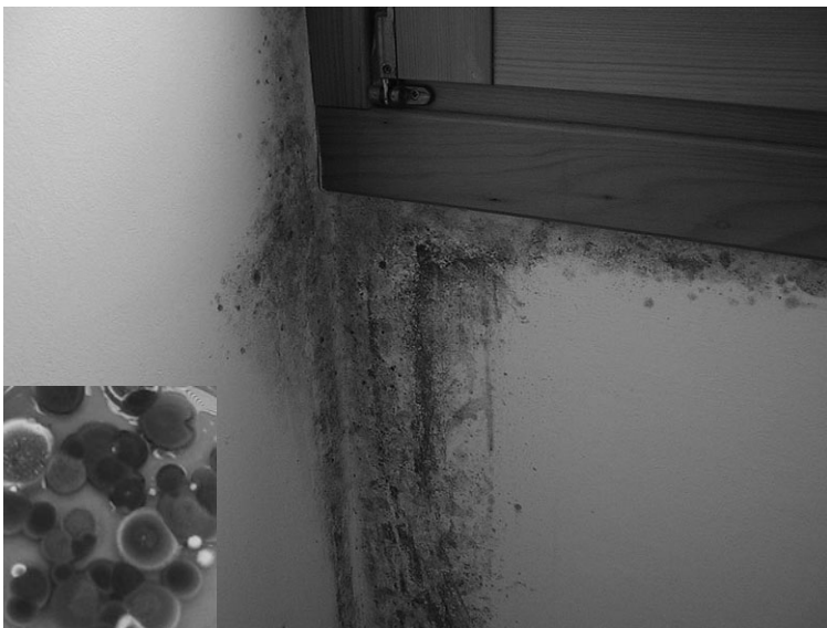
Abb. 4: Pilzbefall durch Feuchtigkeitsanreicherung an der Oberfläche und im Bauteil. Quelle: Innenraum Mess- und Beratungsservice
