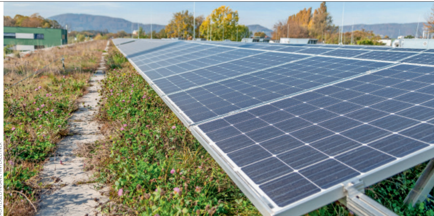
Best-Practice-Beispiel eines Solar Gründaches auf der Werkstatthalle der Graz Holding.
