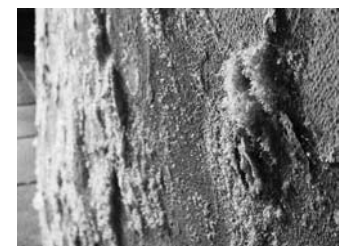
Abb. 9: Ausblühende Mauersalze [Mück]
