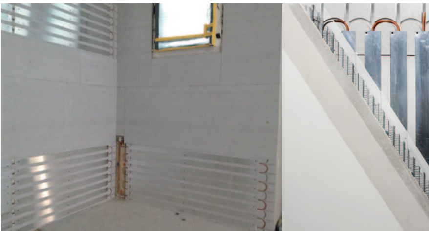
Abb. 1: Feuchteregulierende Klimaplatteninnendämmung in einer Ebene mit Wand Heiz- und Kühlsystem.
