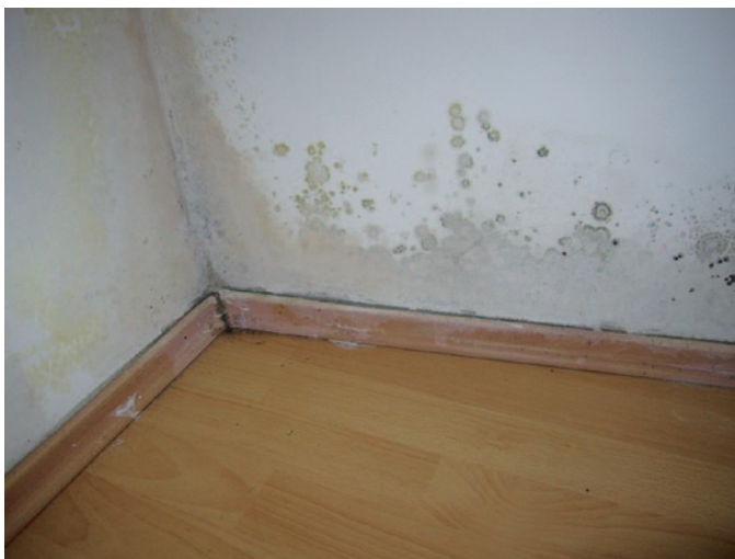
Abb. 1: Typisches Schadensbild von Schimmelbefall infolge Winterkondensation auf Grund unzureichender Beheizung in einem Schlafzimmer im 3. Obergeschoß
