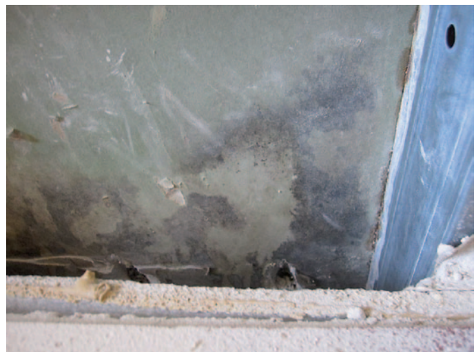
Abb. 2: Schimmelbefall auf der Innenseite einer Leichtbauwand (Gipskarton) infolge einer Leckage im Abfluss der Dusche. Das Gesamtausmaß des Schimmelbefalls war mehrere Quadratmeter groß
