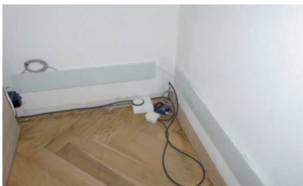
Abb. 6: Heizelemente an der Feuermauer und der einbindenden Innenwand im Bereich der Ecke hinter dem Bett; Mess-System zur Steuerung und Qualitätssicherung
