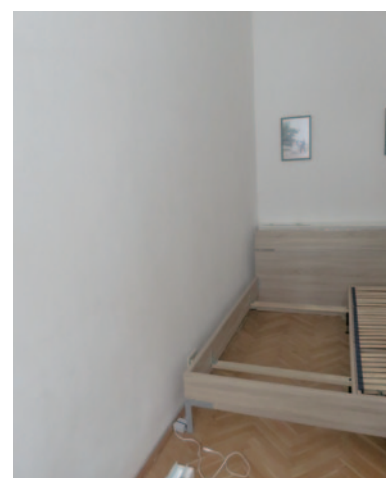
Abb. 3: Kritische Bereiche in der Ecke, der einbindenden Innenwand und entlang der Sockelleiste
