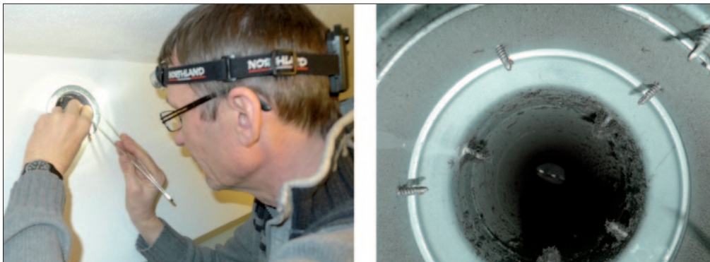
Abb. 4: Hygieneprüfung an Zuluflleitung mit nicht normgerechten, aber häufig zu beobachtenden Verschraubungen von Wickelfalzformstücken
