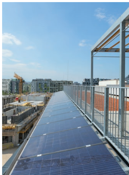
PV-Anlage und Dachterrasse, Foto: © Rupert Steiner
