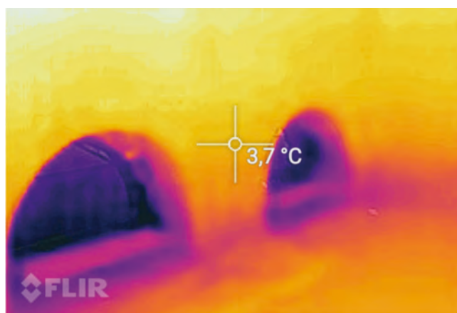
Abb. 8: Thermografieaufnahme zeigt raumseitig einheitliche Oberflächentemperaturen
