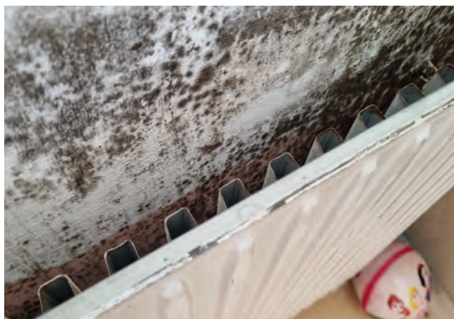
Ursachenermittlung 1: Wohnungsrundgang, Foto ©: Innenraumanalytik OG
