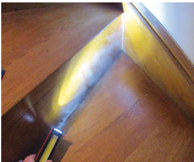
Kanalgeruch aus der Treppenfuge, Foto ©: Innenraumanalytik OG
