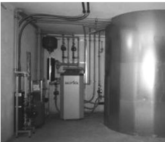
Abb. 4: Pufferspeicher im Heiztechnikraum
