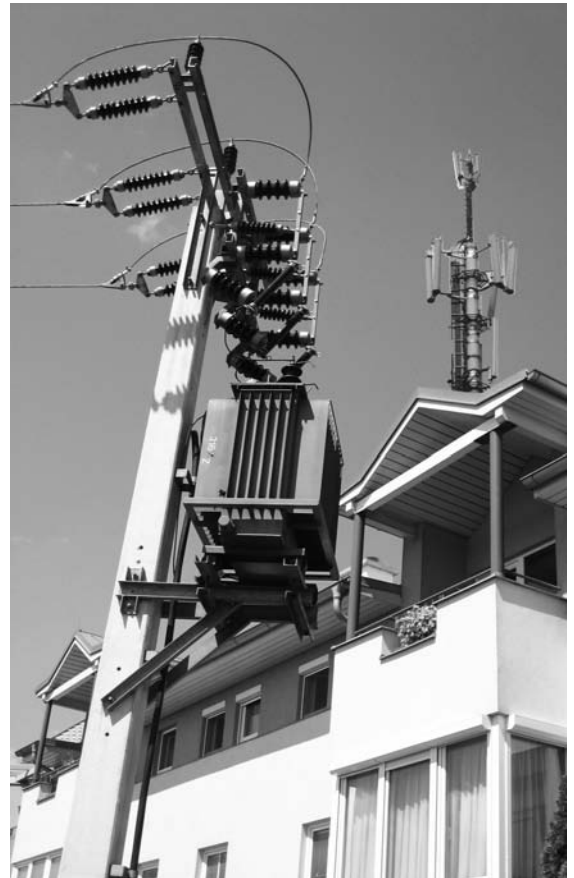
Mögliche Quellen elektromagnetischer Felder im Außenbereich
