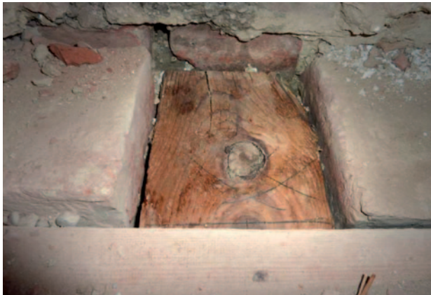
Abb. 5: im Zuge der Sanierungsarbeiten freigelegter Balkenkopf
